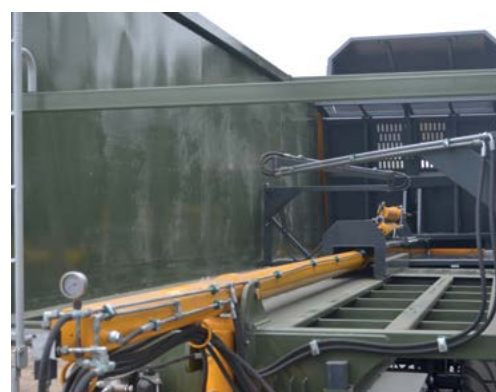
Hydraulický systém pohyblivé stěny
